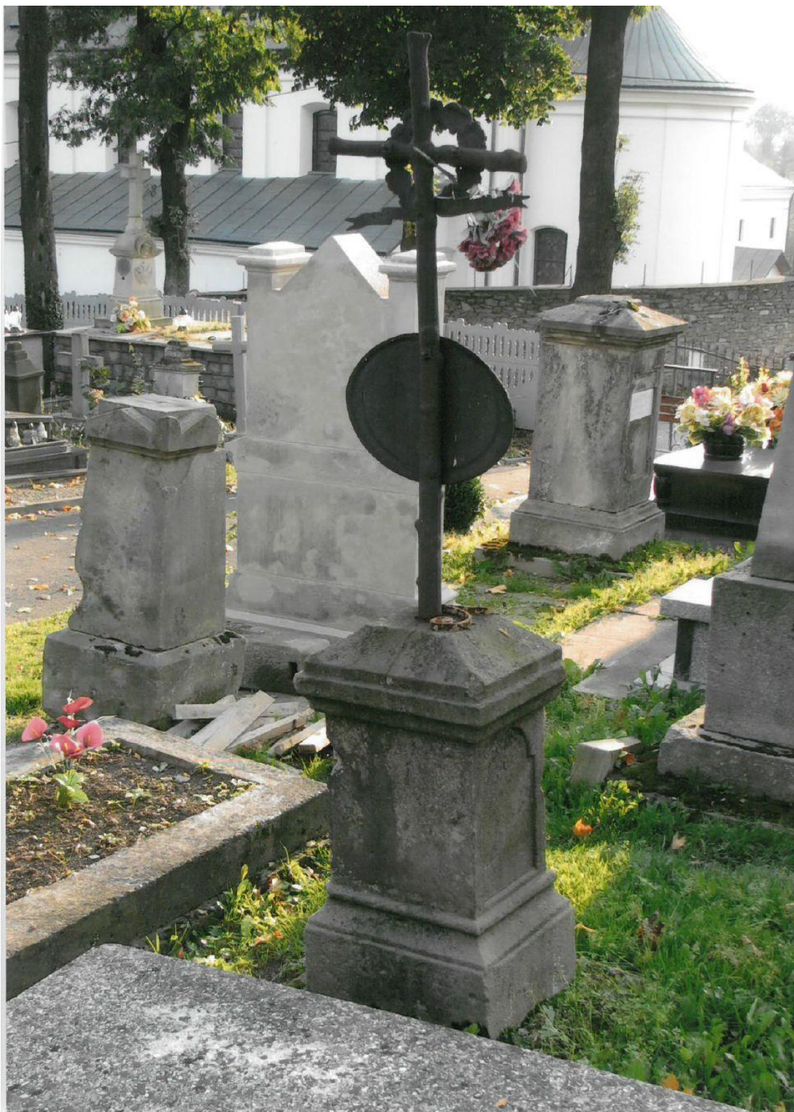
Fot.2 Nagrobek nieznaney osoby, III ćw. XIX w., cmentarz w Dukli. Całość przed konserwacją. Nagrobek zapadnięty do tyłu i na prawy bok. Powierzchnia kamienia mocno zabrudzona, a stopień pokryty grubymi nawarstwieniami mchu. Żeliwny krzyż skorodowany. Październik 2014 r.
