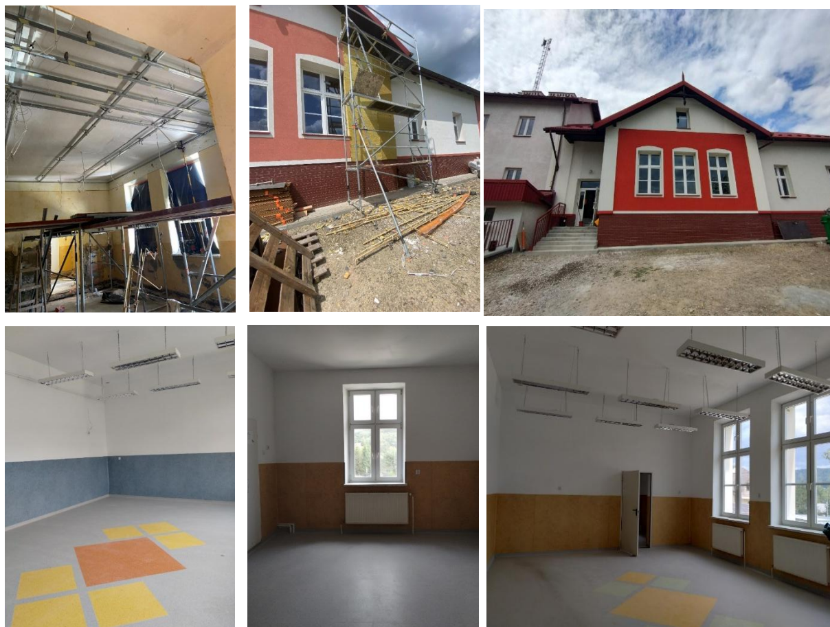
Fot: Szkoła w Tylawie w trakcie modernizacji (zdj. 1 i 2) i po remoncie (zdj. 3,4,5,6)
